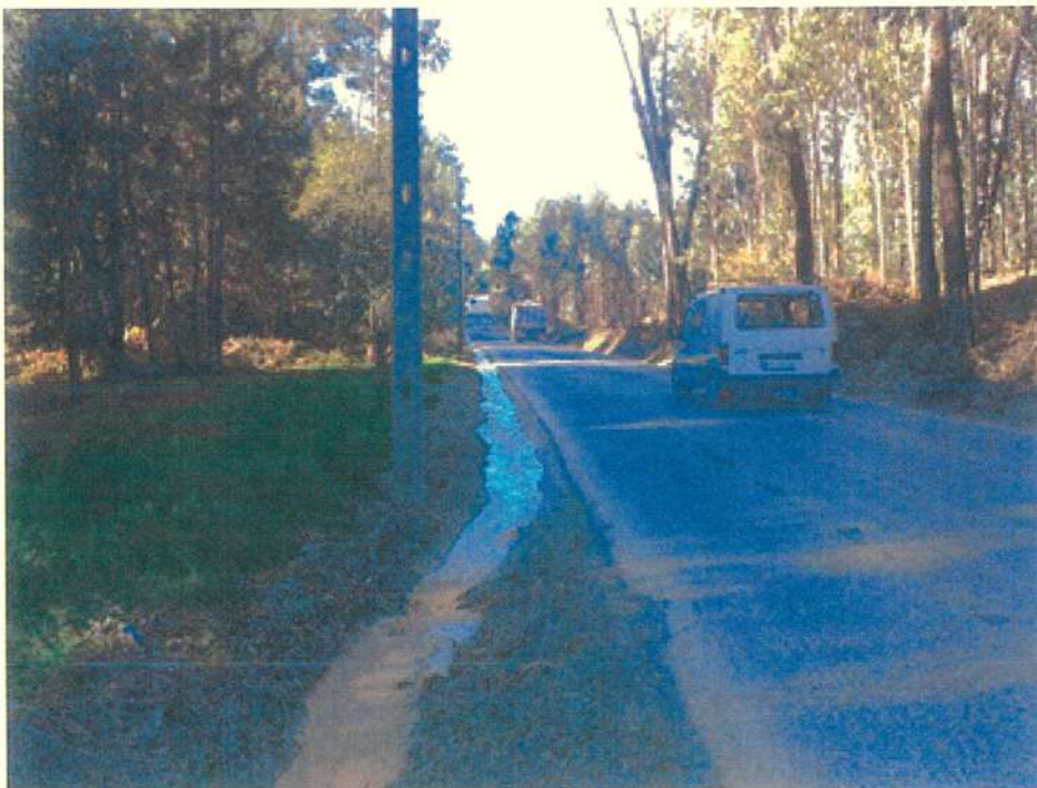
Foto 12: Acesso à localidade do Barracão – Acumulação de areias nas valetas
