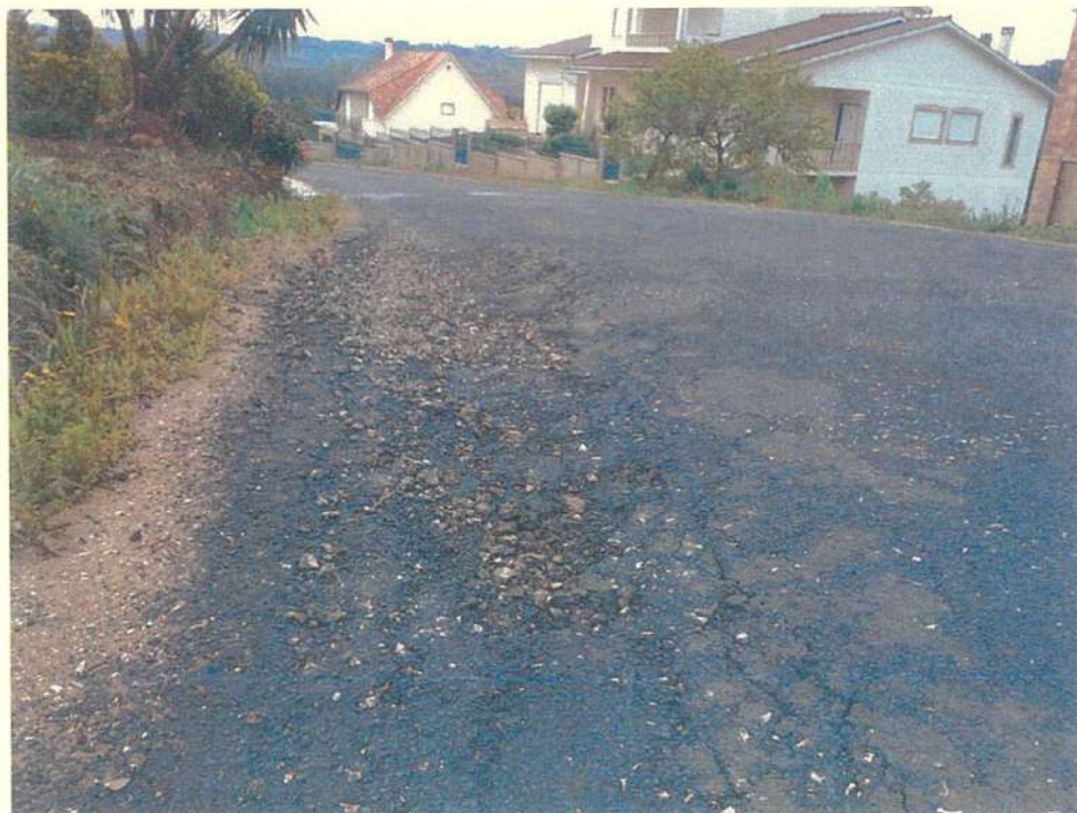
Foto 6: Portela do Outeiro – Mau estado de conservação do pavimento
