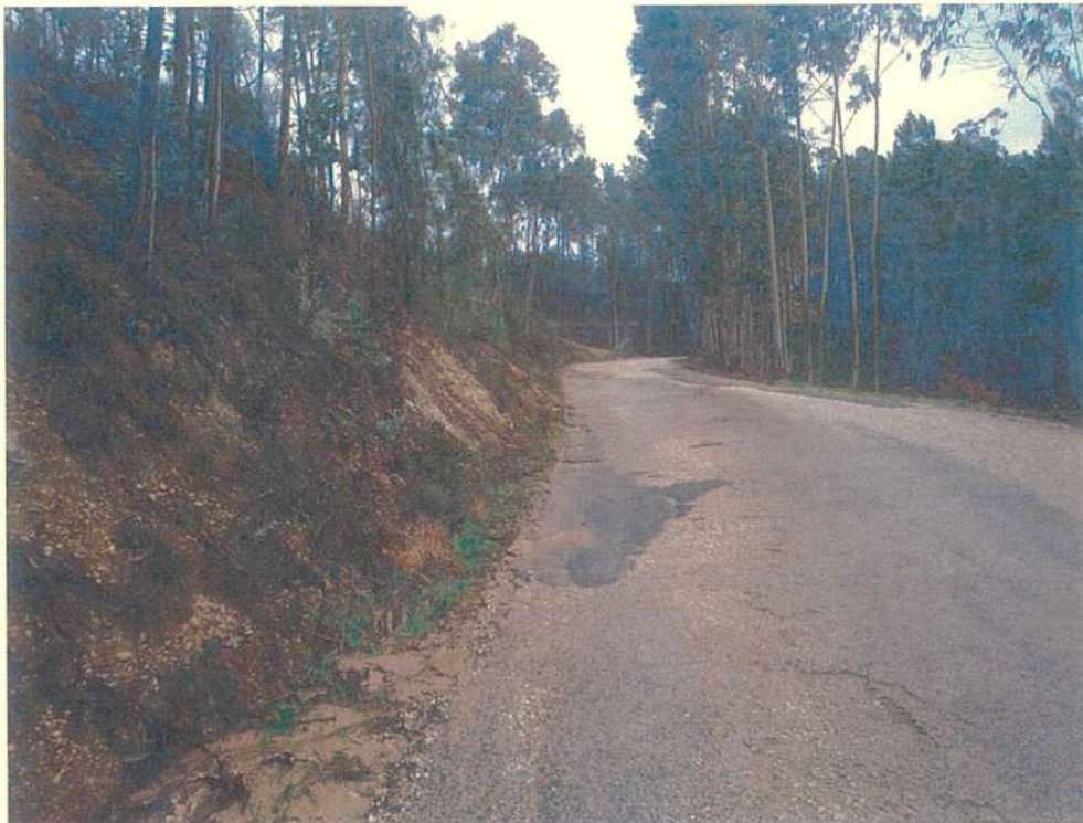
Foto 5: Portela do Outeiro – Mau estado de conservação do pavimento
