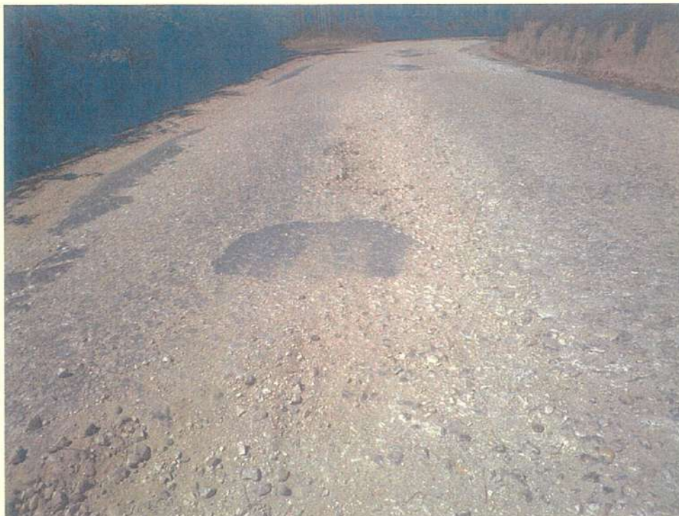
Foto 3: Rua São Miguel – Lugar de Igreja Velha – Mau estado de conservação do pavimento.
