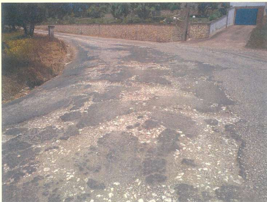
Foto 8: Rua nossa senhora da piedade e Rua São Miguel, na localidade de Igreja Velha – Mau estado de conservação do pavimento dentro da localidade em zona habitacional.
