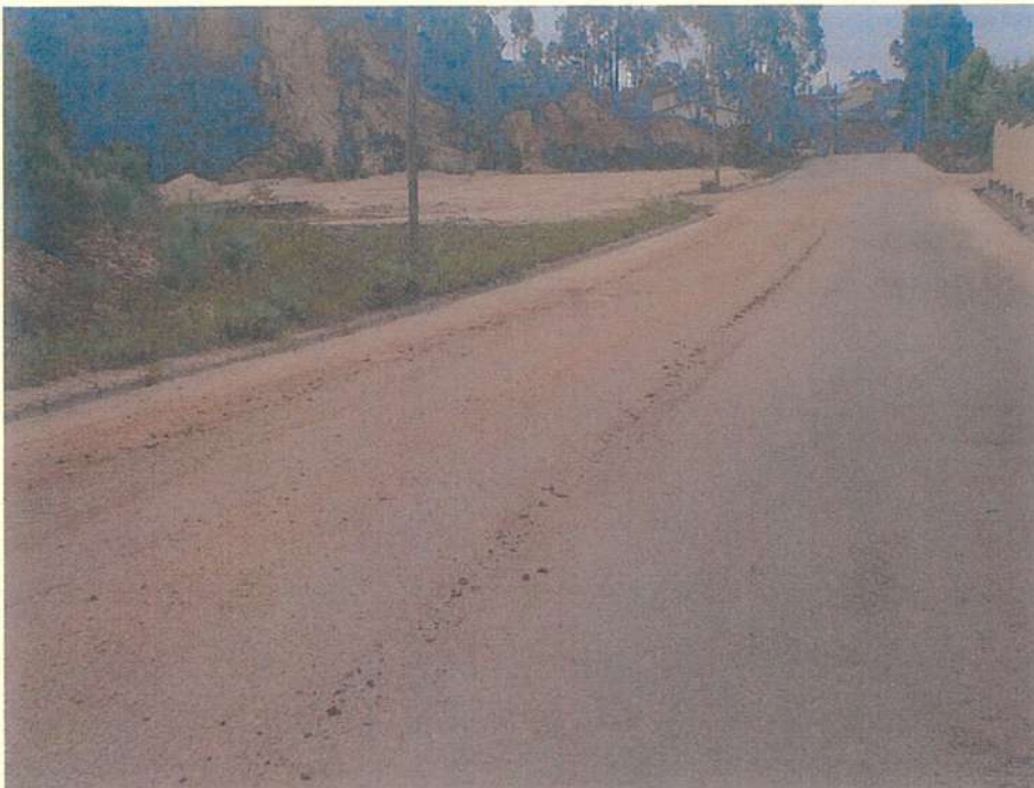
Foto 7: Portela do Outeiro - Acumulação de areias na via oriundos das zonas de exploração.
