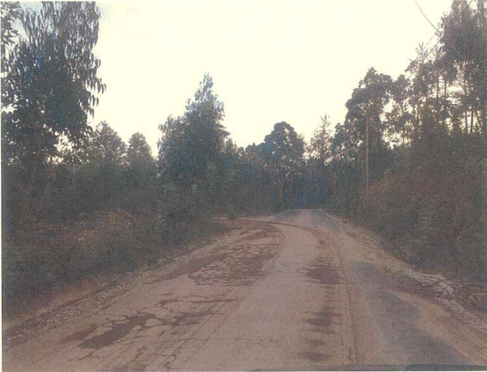
Foto 1: Rua do Brejinho, Igreja Velha a caminho da Serra do Branco – Mau estado de conservação da via com acumulação de areias junto às bermas e via oriundos das zonas de exploração.
